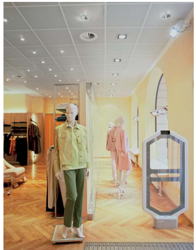
Radialauslass in einer Boutique
