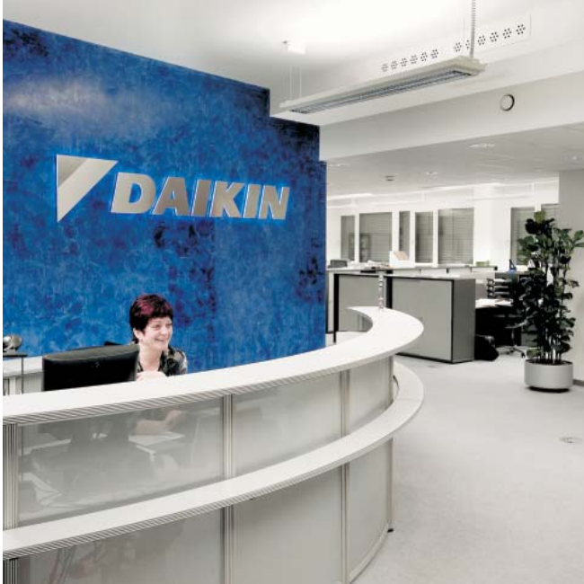
Fächerauslaß, Typ FA- VT in 1-reihiger Ausführung im Eingangsbereich "Daikin Airconditioning Central Europe Handels GmbH", Brunn / A
