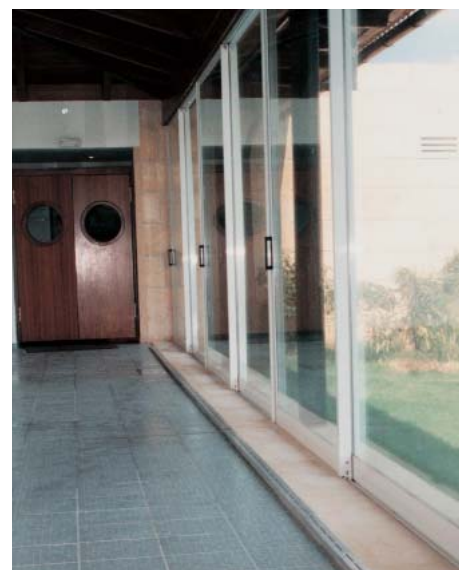
Fensterschleiergerät, Typ FSG in einem Hotel auf Mallorca / E
