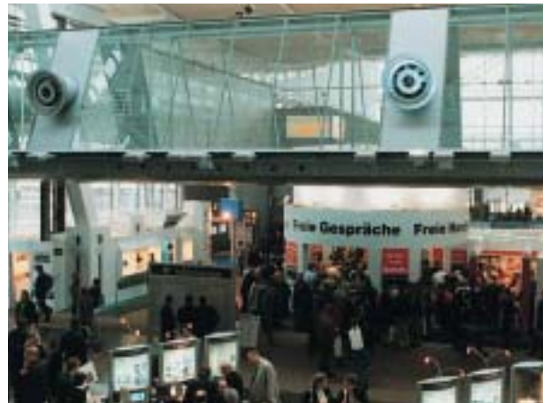
Schwenkbare Weitstrahlauslässe, Typ SW im Zuluft-Glaskanal, Halle 26, Messe Hannover
