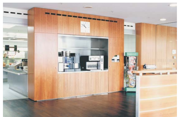
Linearer Wirbelauslaß, Typ WL in der Kantine "Bayerisches Landesamt für Umweltschutz", Augsburg
