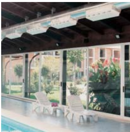
Lineare Wirbelauslässe, Typ WL im Schwimmbad eines Hotels auf Mallorca / E
