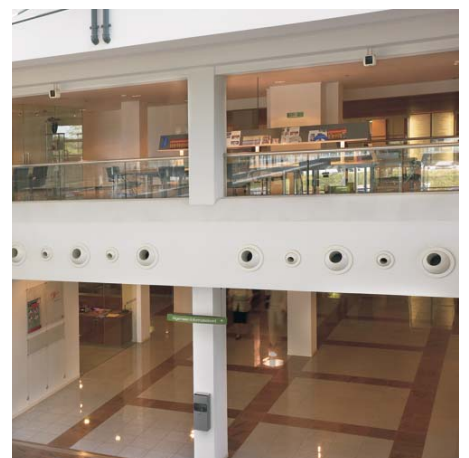
Schwenkbare Weitwurfdüse, Typ DW-N2 im Atrium Medisch Centrum, Heerlen / NL
