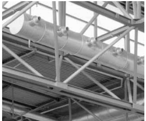
Bild 11: Typ DW-N2 an der Decke in "Neue Messe Leipzig"
