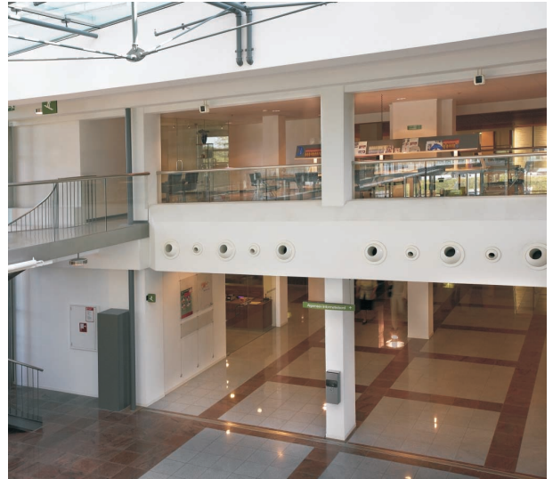
Bild 10: Typ DW-V2 im Atrium Medisch Centrum, Heerlen, NL
