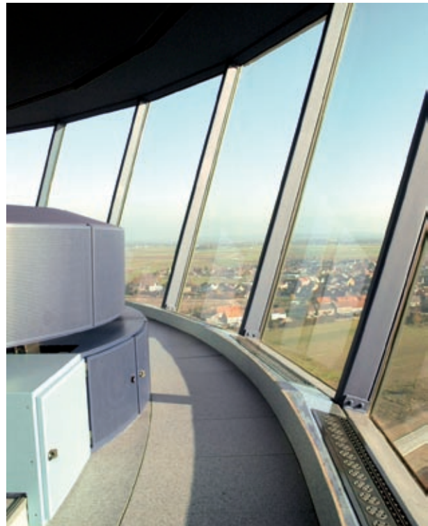
Bild 5: Brüstungsauslass in einem Flughafen-Kontrollturm (Belgocontrol in Brüssel)
