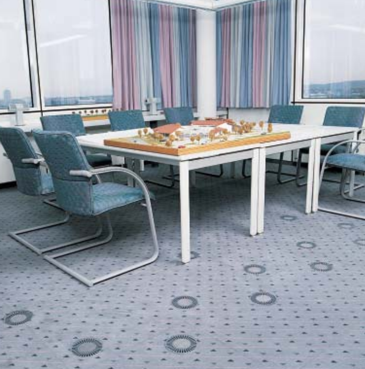
NTK-Bodendrallauslaß im Bürogebäude DEKRA, Stuttgart
