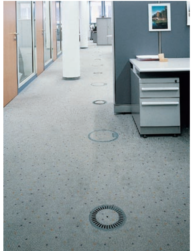
Bild 5: NTK-Bodendrallauslass in einem Bürogebäude
