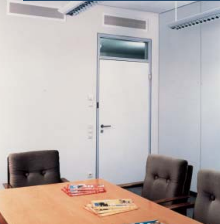
Wandquellauslaß, Typ Q-WL in einem Besprechungsraum
