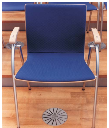
Bild oben und unten: Bodenquellauslaß, Typ Q-B-DN 200 im Congress Centrum, Frankfurt a.M.
