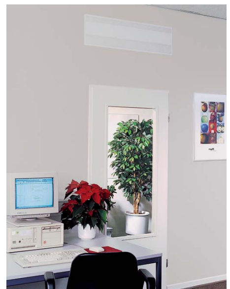
Wandquellauslaß, Typ Q-WK in einem Büroraum
