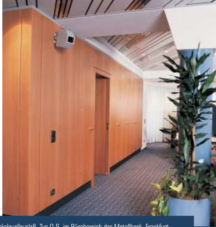
Sockelquellauslaß, Typ Q-S im Bürobereich der Metallbank, Frankfurt
