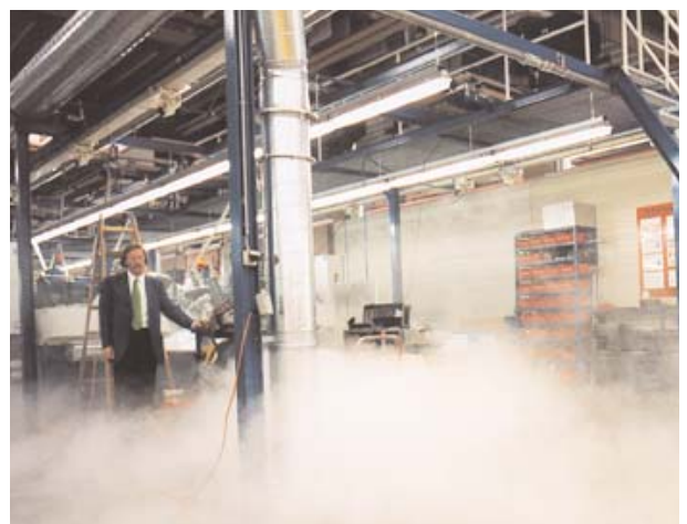
Runder Verdrängungsauslaß, Typ VA-ZD auf dem Boden der Fertigungshalle der Firma "Stihl & Co.", Wil / CH
