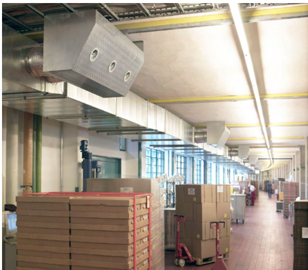
Bild 9: Halbtrapezförmiger Verdrängungsauslass, Baugröße 500 in einem Produktionsbetrieb
