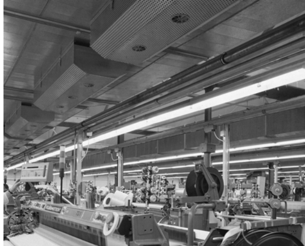
Bild 5: Trapezförmige Verdrängungsauslässe am Zuluftkanal einer Weberei
