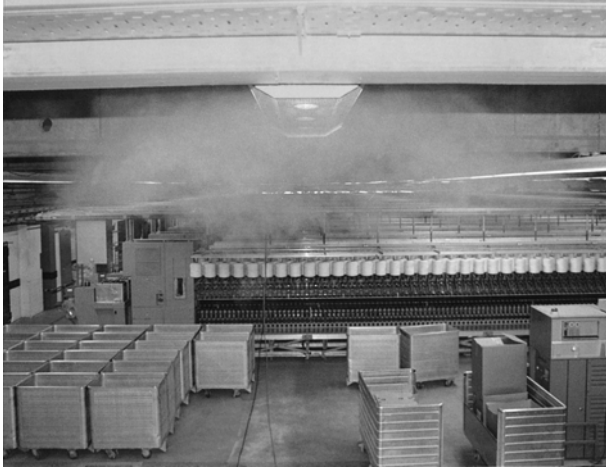
Bild 3: Trapezförmiger Verdrängungsauslass, Strahlausbreitung durch Rauchprobe sichtbar
