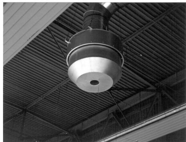
Bild 2: Kegelförmiger Verdrängungsauslaß an der Decke einer 26 m hohen Halle
