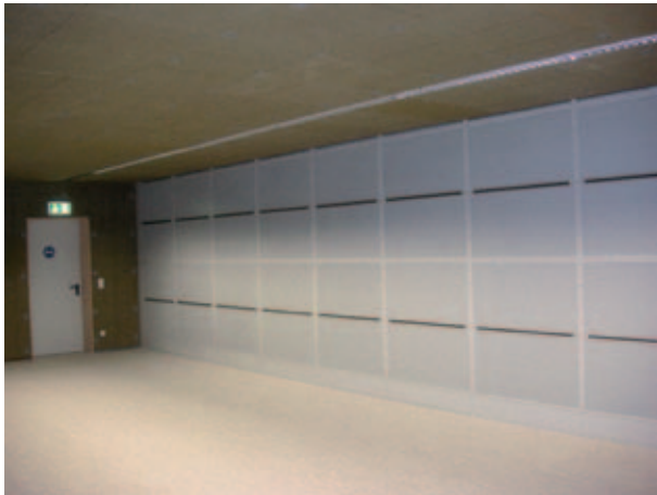
Zuluftwand mit Lochblechkassetten und Schlitzauslässen
