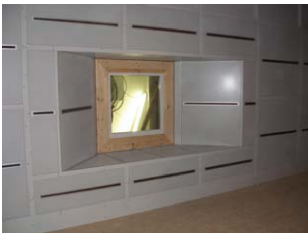
Zuluftwand mit Lochblechkassetten und Schlitzauslässen. Schützensaufsichtsfenster mit luftführenden Lochblechkassetten.
