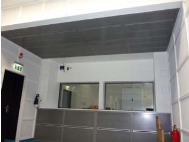
Raumschießanlage mit Zuluftdecke und -wand
