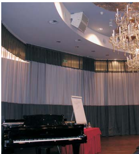
Radialauslässe im Konzertgebäude - Chorsaal, Amsterdam / NL
