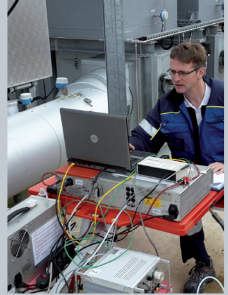
Funktionsprüfungen an einer thermischen Nachverbrennungsanlage
