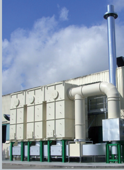
Nachverbrennungsanlage mit Wärmerückgewinnung zur Emissionsminderung
