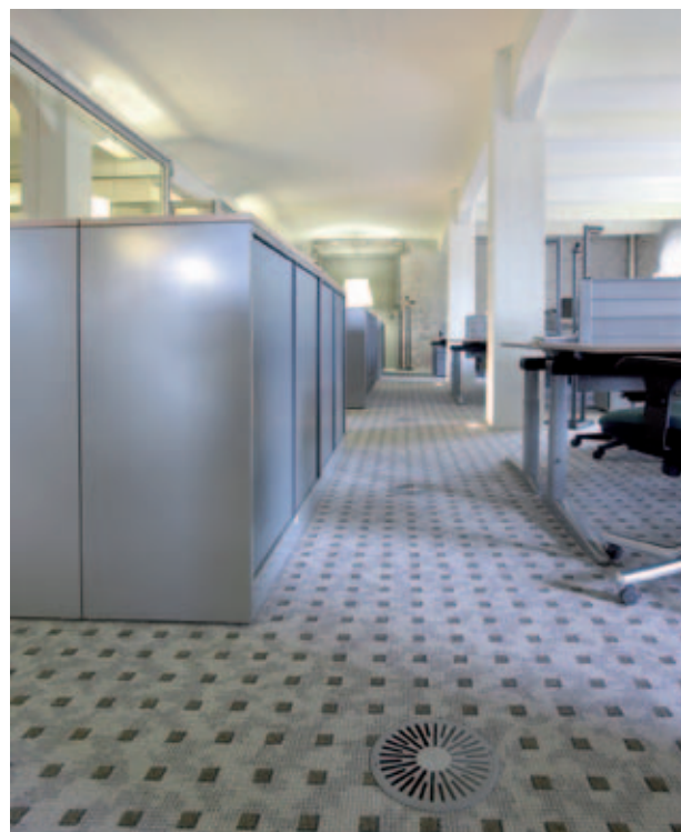
Bild 6: Bodendrallauslass in einem Büroraum
