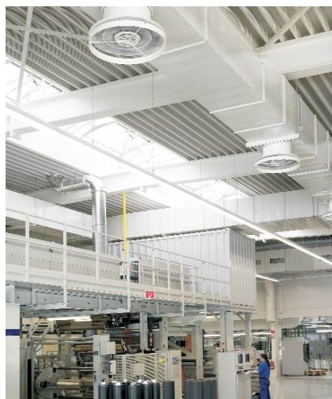
Radial displacement outlet with guide ring at Scheyer Verpackungstechnik GmbH, Klaus-Weiler / A
