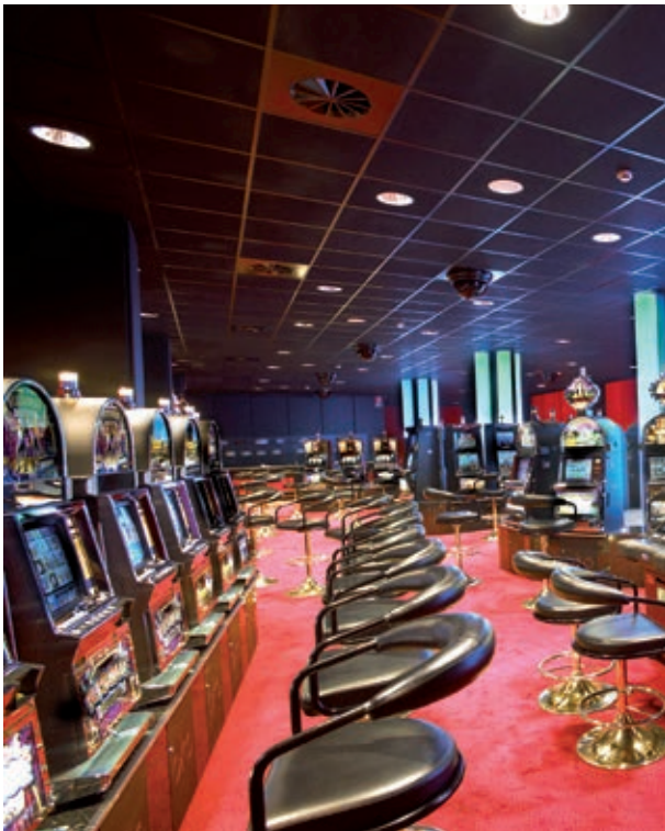
Radialauslass mit quadratischer Sichtfläche in einem Spielkasino
