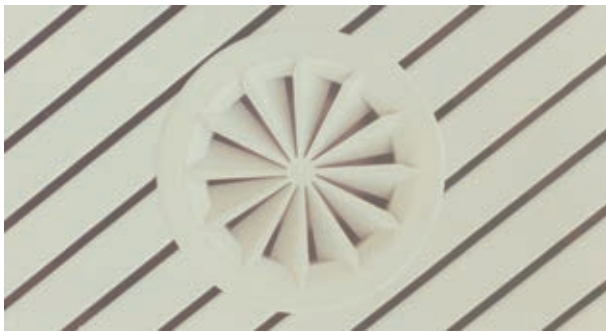
Radialauslass in einer Paneeldecke
