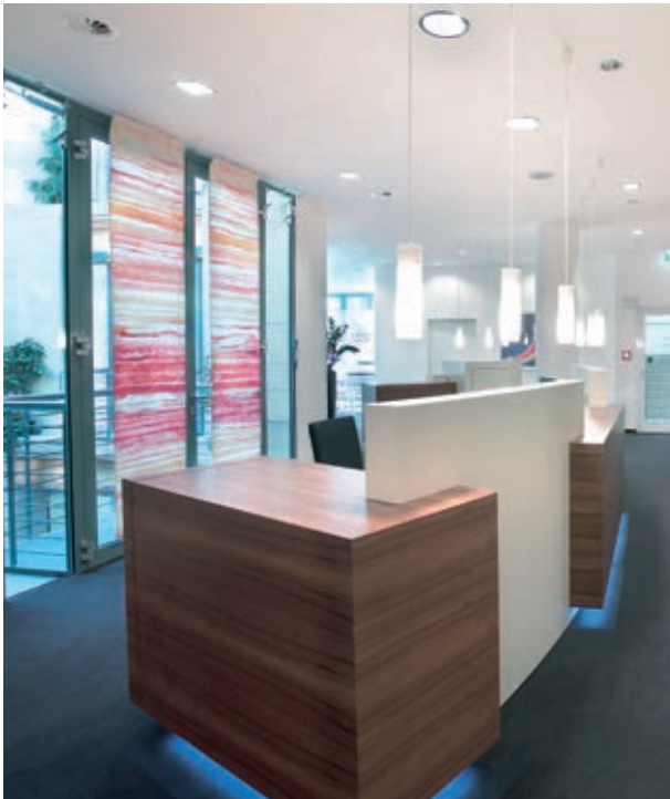
Radialauslass mit runder Sichtfläche in einem Empfangsbereich
