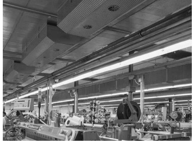
Bild 8: Trapezförmige Verdrängungsauslässe am Zuluftkanal einer Weberei
