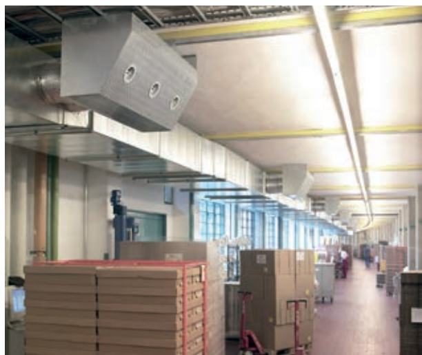
Bild 12: Halbtrapezförmiger Verdrängungsauslass, Baugröße 500 in einem Produktionsbetrieb
