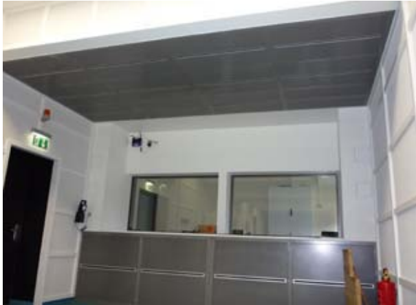
Raumschießanlage mit Zuluftdecke und -wand
