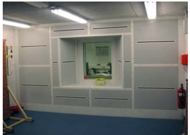
Neue Ausführung Luftauslasswand Fabrikat Krantz Komponenten mit Erreichung der optimalen Raumluftgeschwindigkeit und Strömungsrichtung
