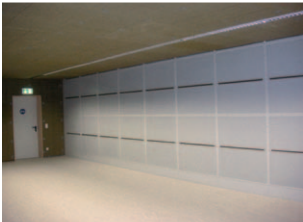
Luftauslasswand mit Lochblechkassetten und Induktivauslässen
