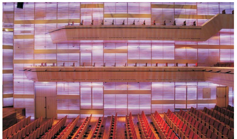
Jet nozzles and seat displacement outlets in the 'Muziekgebouw aan 't IJ', Amsterdam / NL
