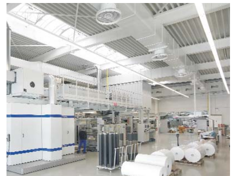
Radial displacement outlet, type VA-PV, at 'Scheyer Verpackungstechnik GmbH', Klaus / A
