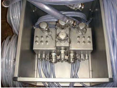
Abb. 2: „Oktopus“ (H 2 O 2 -Verteiler) (Quelle: Caverion Deutschland GmbH, Krantz Filter- und Absperrsysteme).
