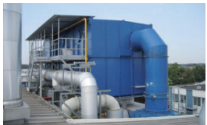
Abb. 4: Seitenansicht der neuen RNV mit heißem Bypass
