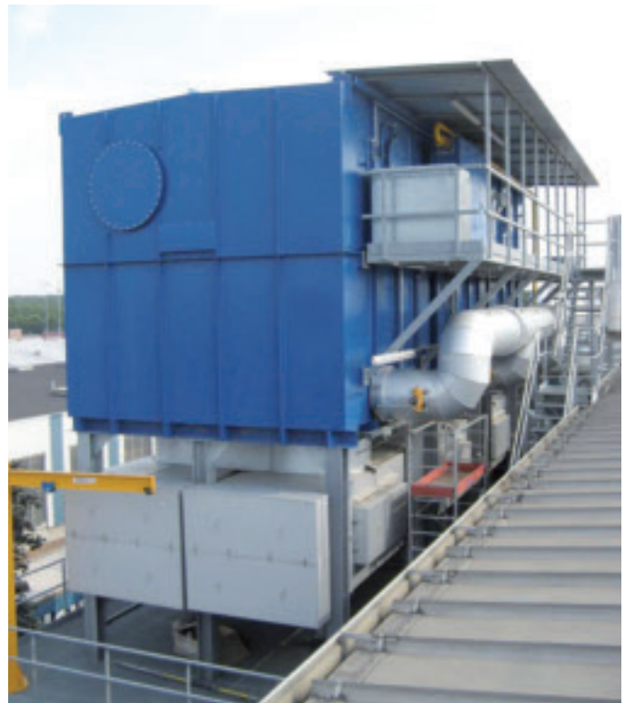
Abb. 6: Seitenansicht der neuen RNV mit Brennerbühne
