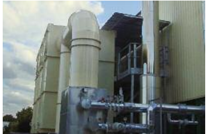
Abb. 3: Rückansicht der RNV. Im Vordergrund Wärmerückgewinnung und Kamin.
