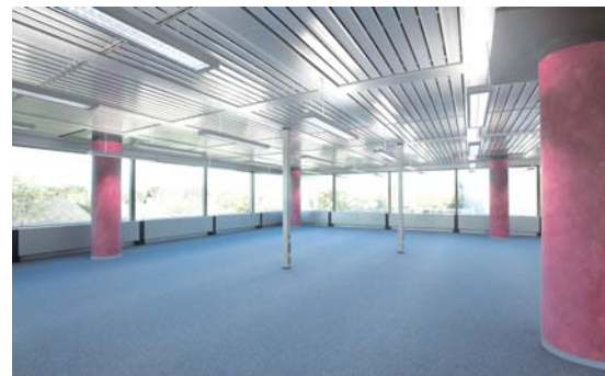
Abb.1 Das umgebaute Großraumbüro mit Kühlelementen als sichtbare Installation
