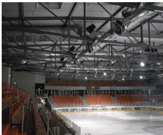
Bild 1: In der Eisarena Wolfsburg wurde ein innovatives Lüftungskonzept realisiert
